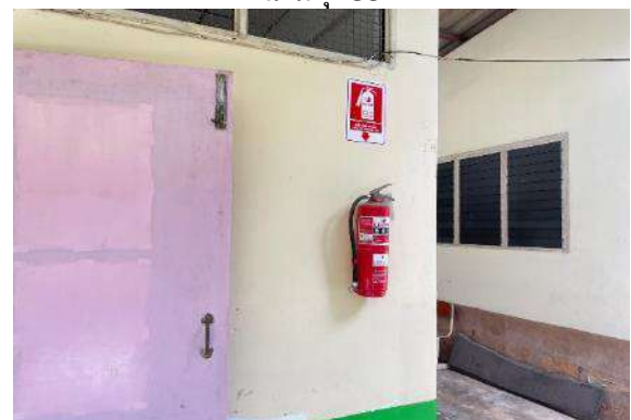
ถังดับเพลิง
